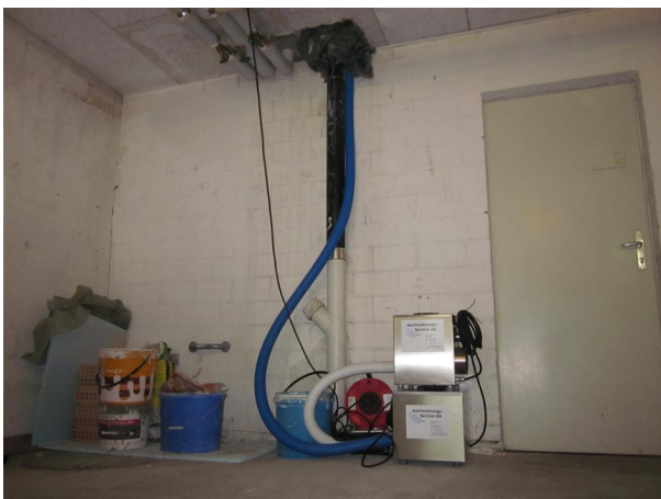
Schachttrocknung von unten
